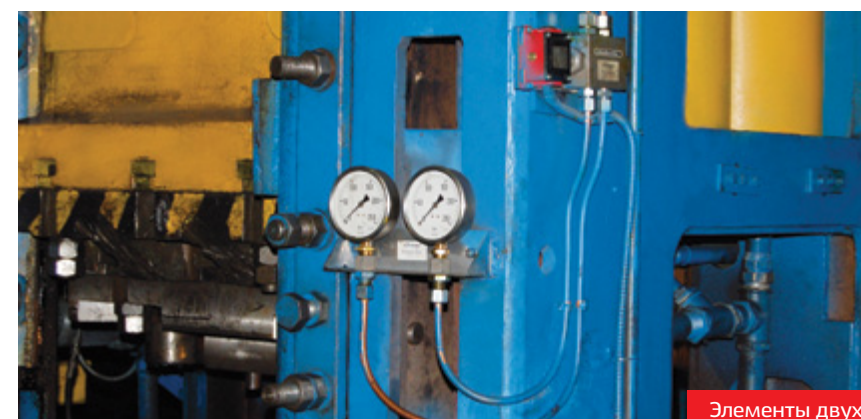
Система заправки смазки. Пневматический бочковый насос автоматически подкачивает смазку в станцию (по сигналу инфракрасного датчика) Grease filling system. Pneumatic barrel pump pumps grease into the unit (by infra-red gauge signal)
